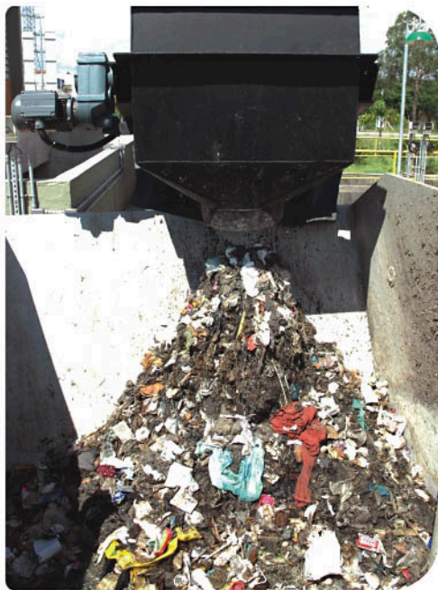
Esteiras de gradeamento grosso da ETE: detritos que encarecem o tratamento
